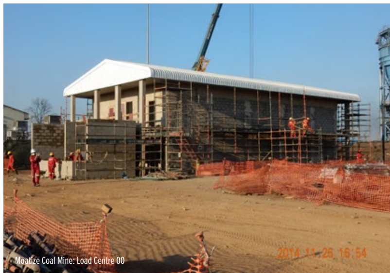
Qatum Gleichrichteranlage: Gleichrichterstation
