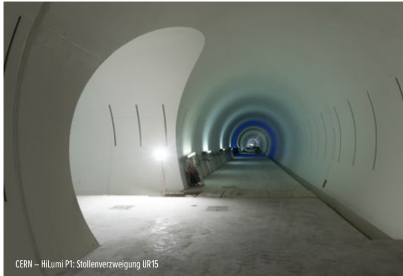
PSW Limmern: Transformatorkaverne
