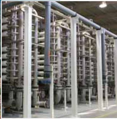
Sulaibiya WWTP, Kuwait
