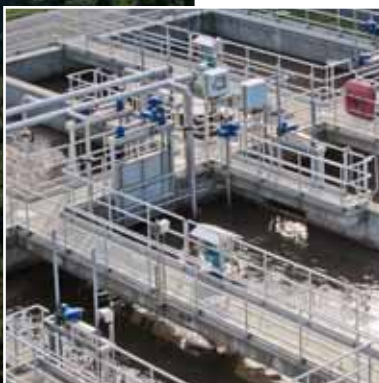
Leibnitz WWTP, Austria
