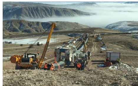
Transanatolische Erdgas-Pipeline (TANAP), TUR
