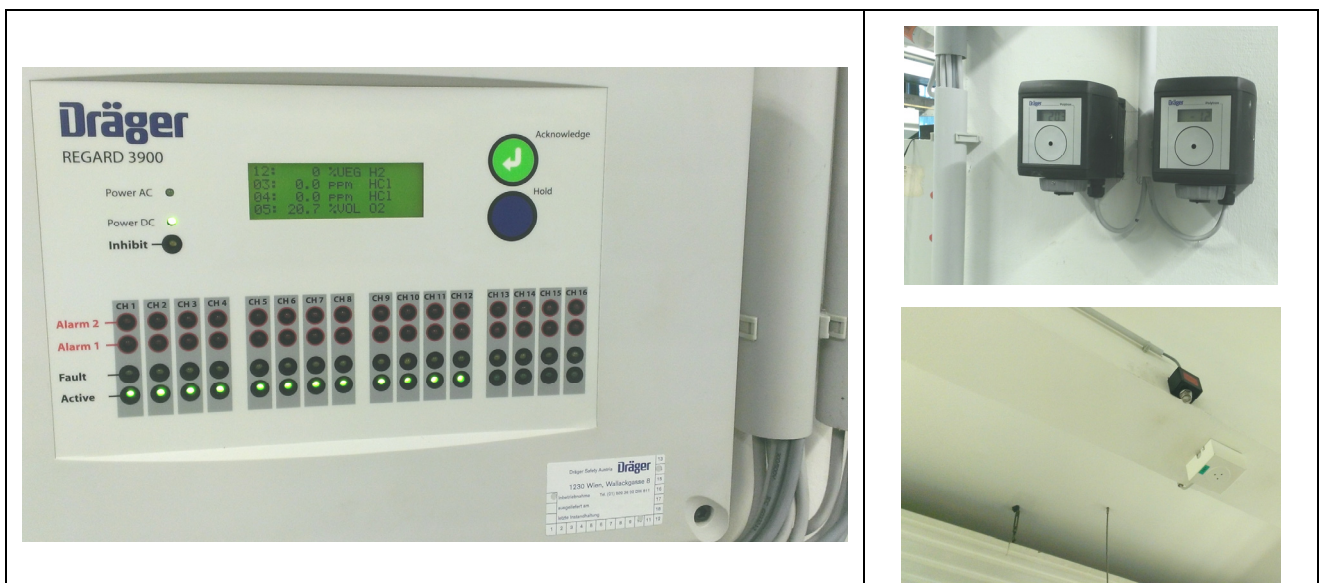
Abbildung 16: Fix installiertes Gaswarnsystem
